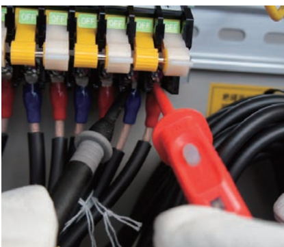
无需遮光在汇流箱即可进行检查
